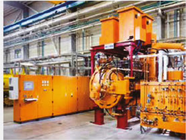
1 Drucksinteranlage mit Schaltschrank
